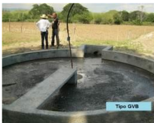
Figura 2. Digestor de 36 m 3 , Finca Tierra Brava.
